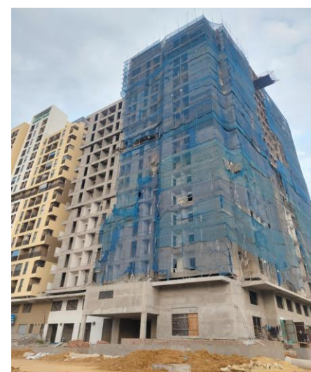
NHÀ Ở XÃ HỘI SỐ 2, CHUNG CƯ CAO TẦNG - TP. LẠNG SƠN
